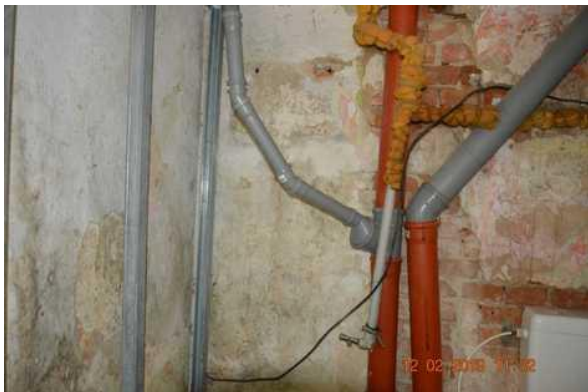
13. stav kanalizace s přerušeným potrubím
